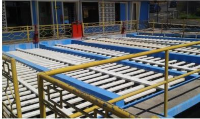
Figura 13. Sedimentador convencionales y laminar de la planta potabilizadora
