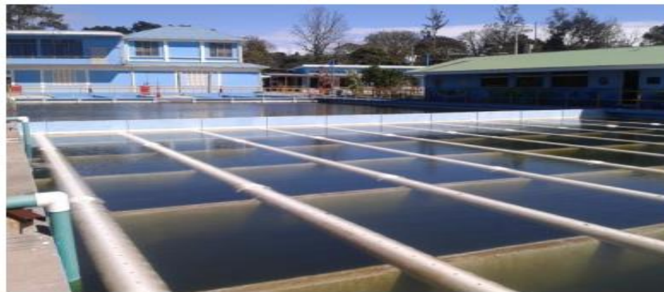
Figura 14. Sección de mezclador Tiribí- Orosi, sedimentador convencional (al frente) y laminar (detrás)
