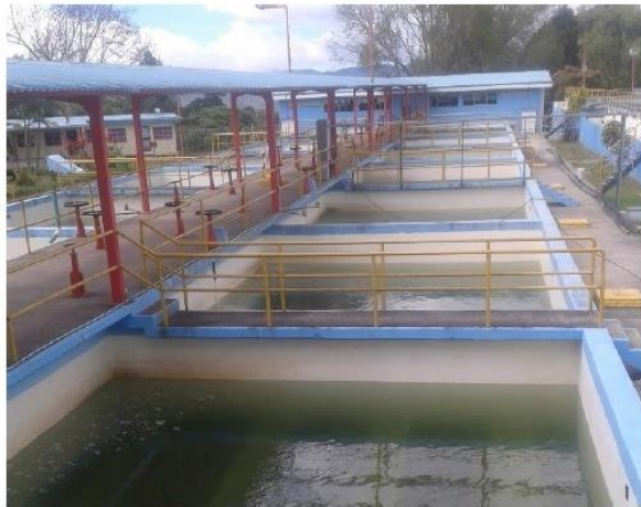
Figura 20. Filtro de flujo descendente y batería de filtración rápida
