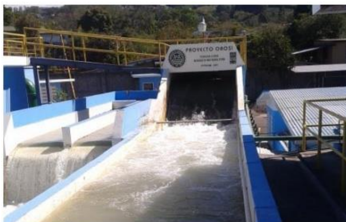
Figura 15. Mezcla rápida tipo rampa, sección Orosi
