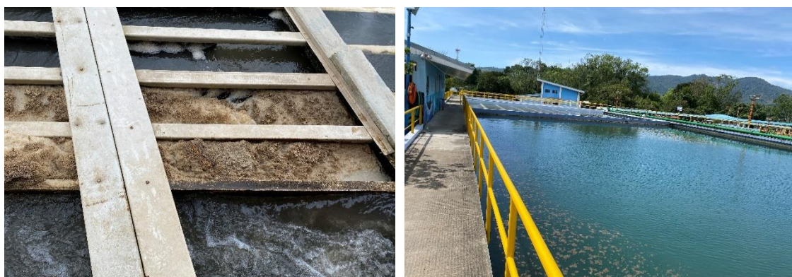
Figura 21. Presencia de espumas en el floculador
