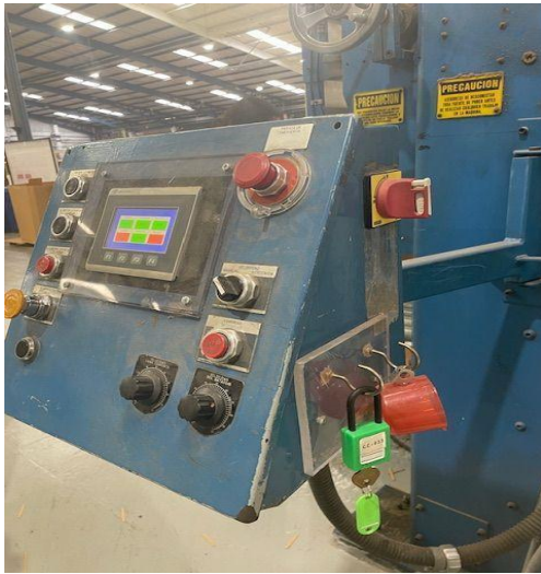
Figura 6 - Punto de aislamiento y dispositivo de bloqueo del Stacker
