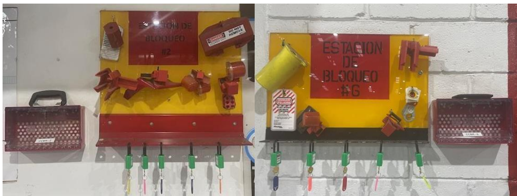
Figura 5 - Estaciones de bloqueo en la planta de producción
