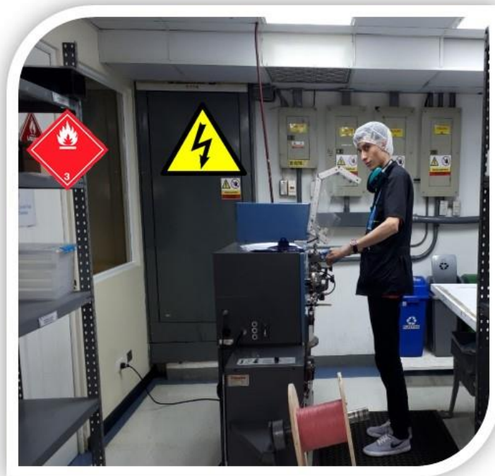
Figura 15. Paneles eléctricos principales sin restricción de acceso.
