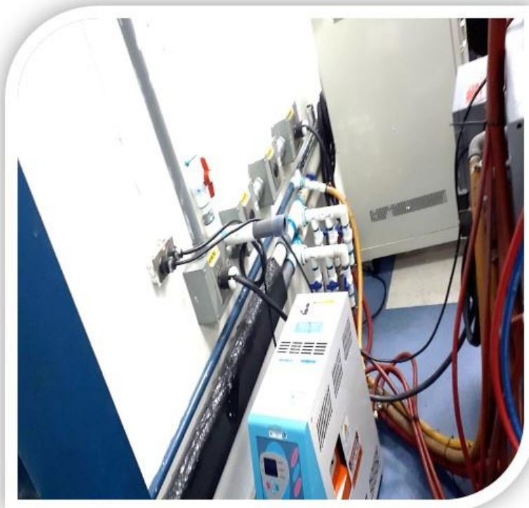
Figura 7. Espacio limitado entre maquinaria.
