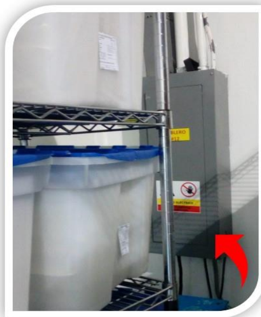
Figura 16. Paneles eléctricos bloqueados
