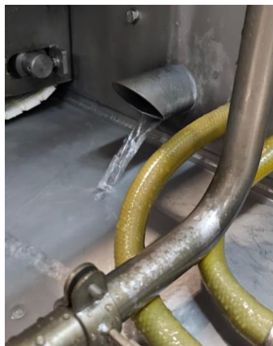
Figura 38 Salida de agua del sistema de aire estéril
