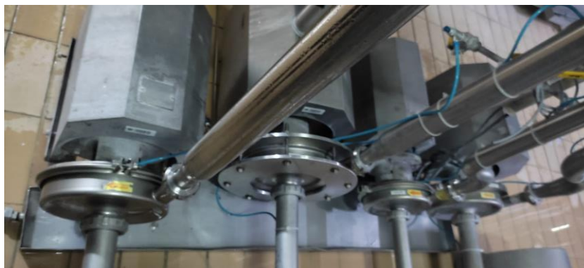
Figura 41 Bombas de trasiego de izquierda a derecha, U7, U8, U4, U1.
