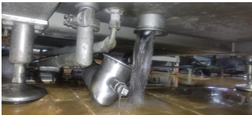
Figura 40 Salida de agua residual debajo de la llenadora A3
