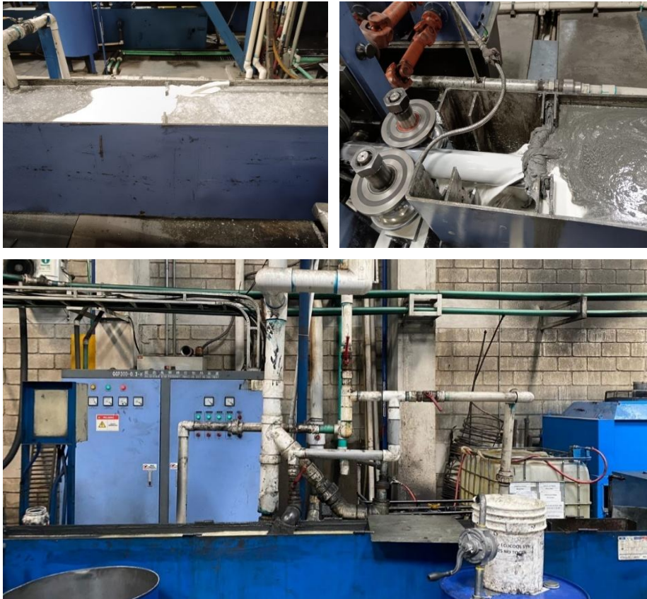
Figura 11. Pileta de enfriamiento Fuente: Elaboración propia, 2024.
