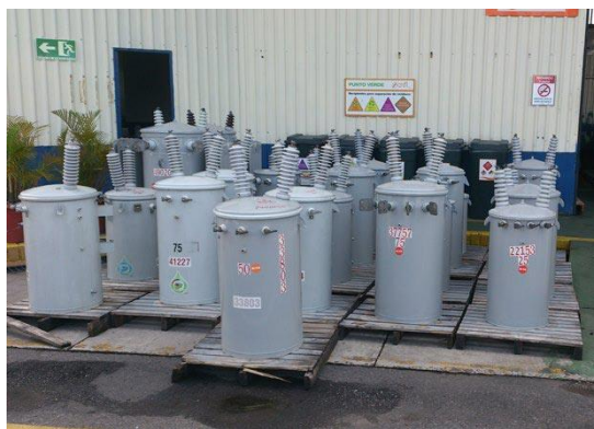
Figura 11. Transformadores Fuente: Procesos CTM.
