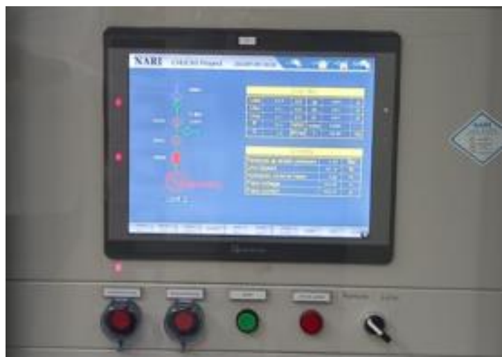
Ilustración 5 Panel de Control y Monitoreo
