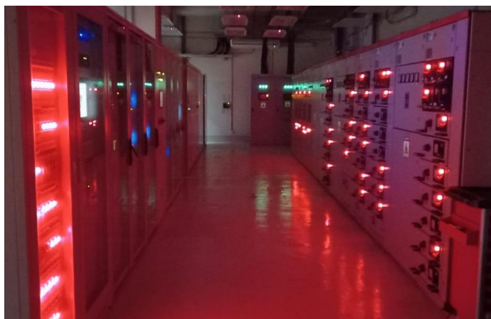
Ilustración 3 Cuarto de Potencia
